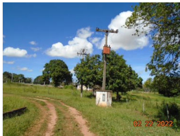
Figura 3.21 – Poste de distribuição com transformador
