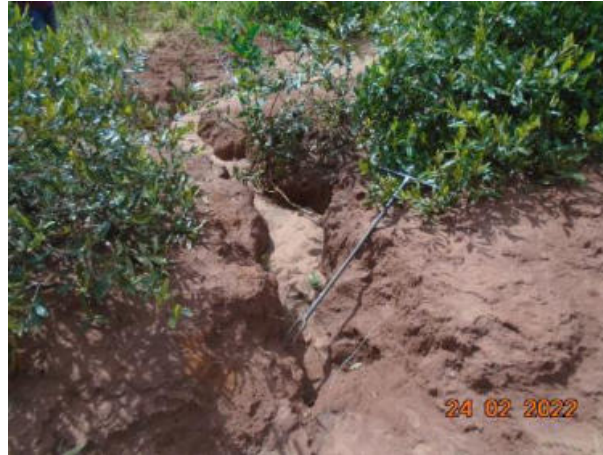
Figura 5.71 – Processo erosivo observado na unidade TT
