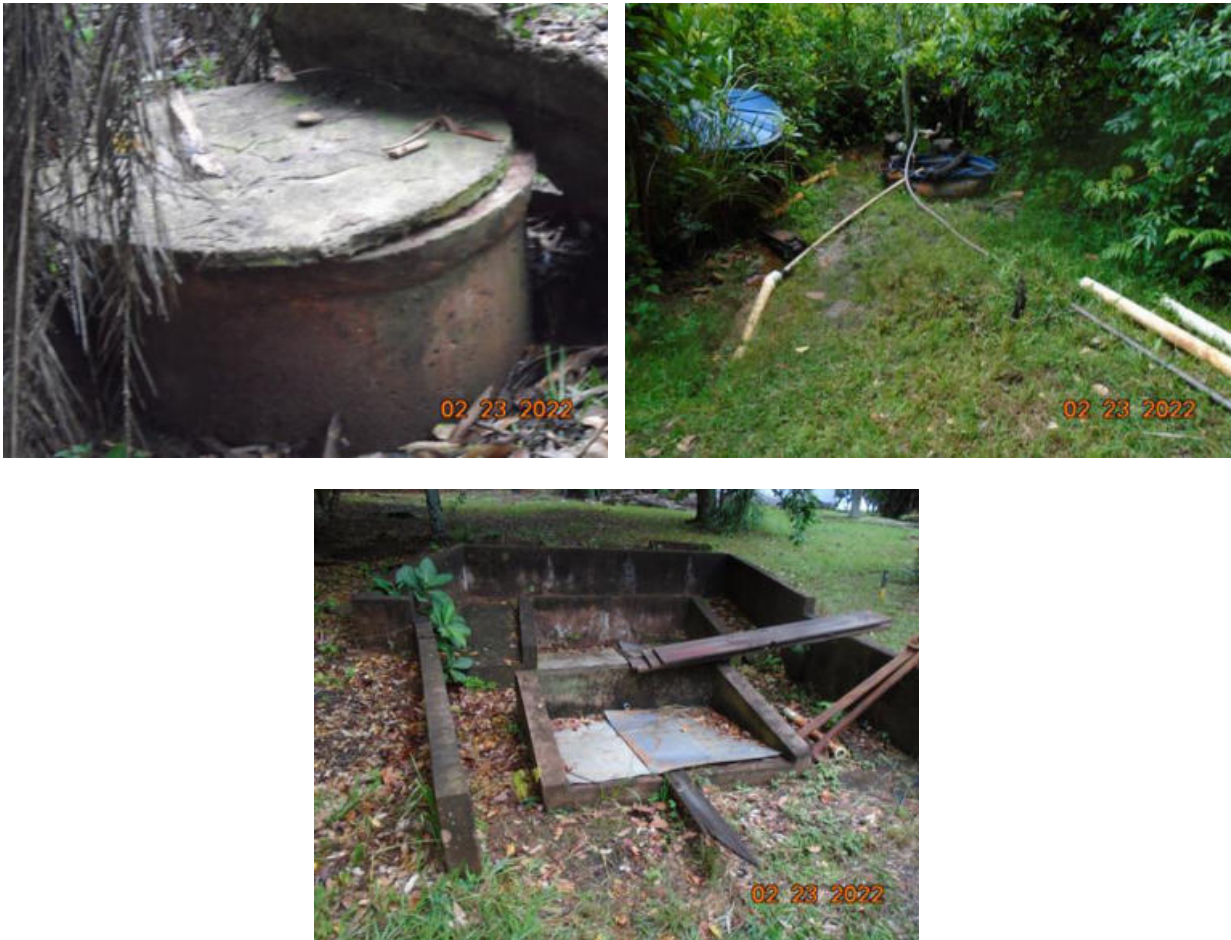
Figura 3.68 – Poço d’água, sistema de bombeamento de água e tanque reservatório de água em alvenaria
