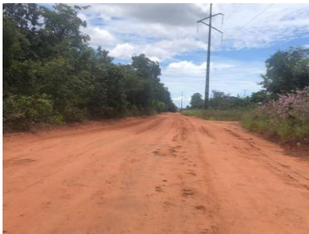
Figura 5.259 – Vias sem pavimentação asfáltica
